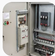
Szafy telekomunikacyjne i panele techniczne
