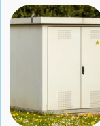
Nutsvoorzieningskasten en behuizingen
