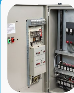
Telecomkasten en technische panelen
